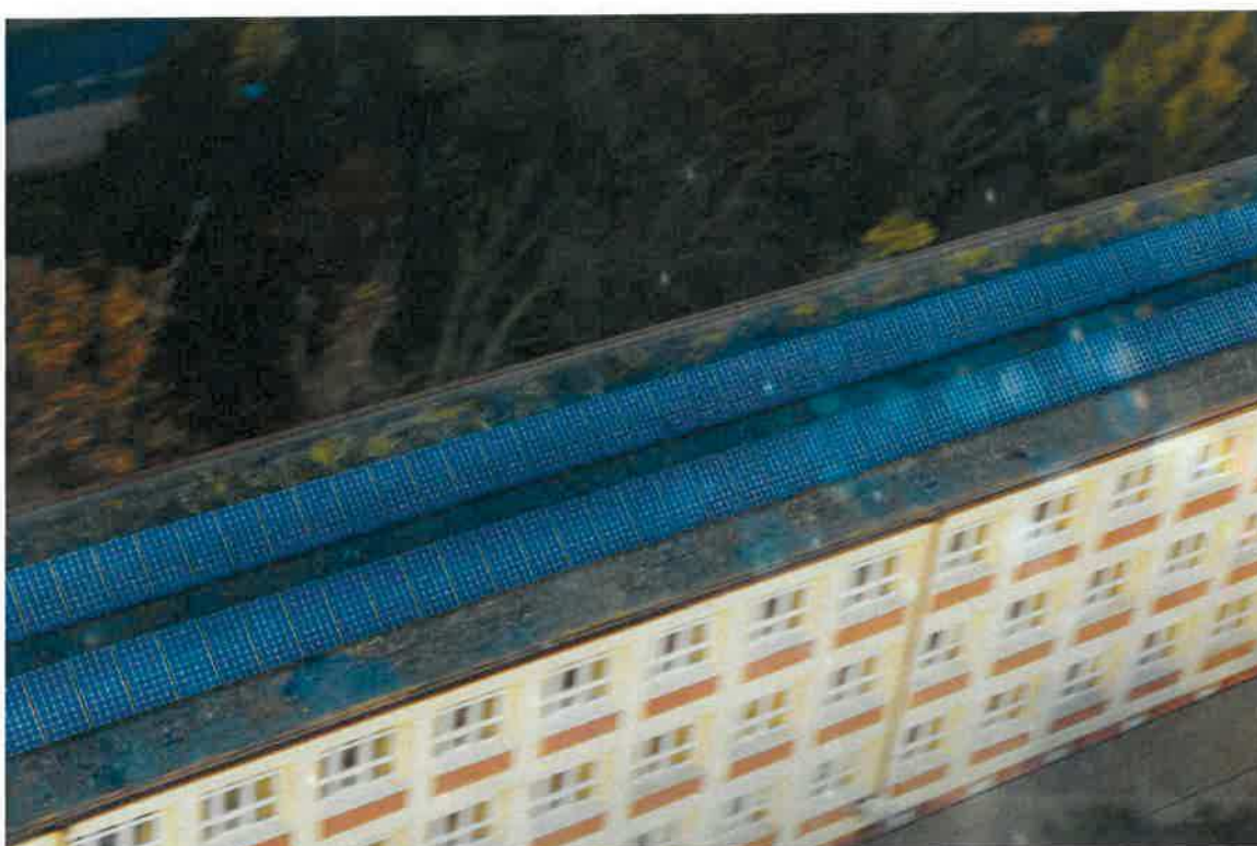
Fot. 2.4. Panele fotowoltaiczne na dachu budynku B
